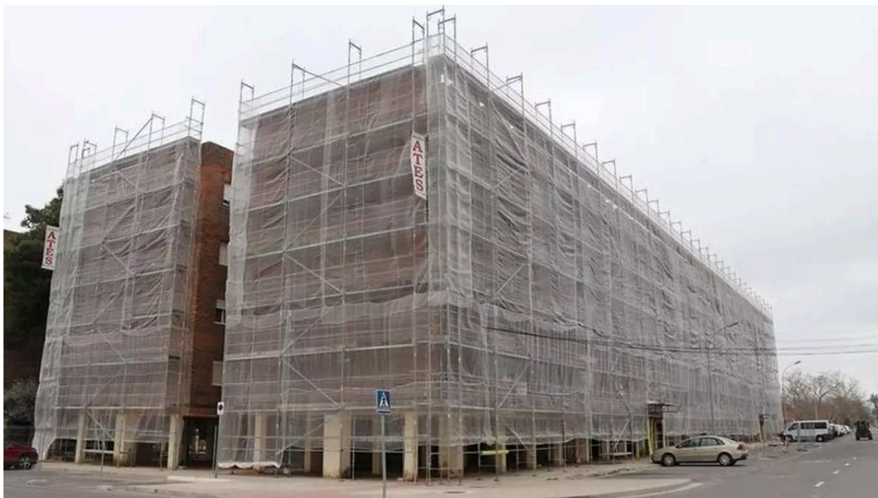
Fincas ya con andamios en el barrio de Baladre de Sagunt. / Ayuntamiento de Sagunt
